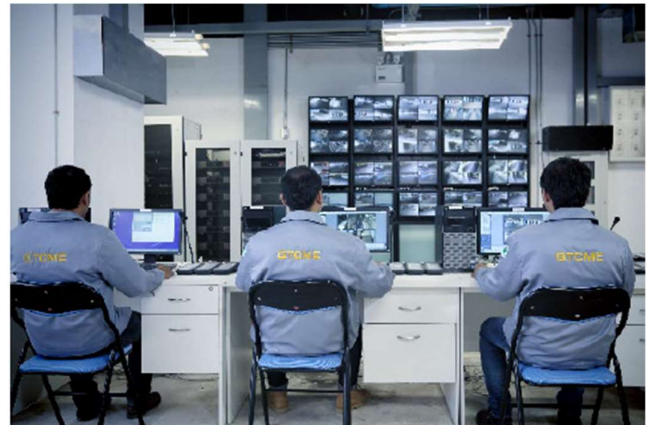
ระบบกล้องวงจรปิด (CCTV system)
